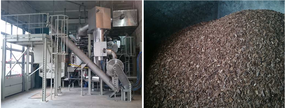
Unité pilote TORPLANT à Orbe (CH) - capacité 100 kg/h
